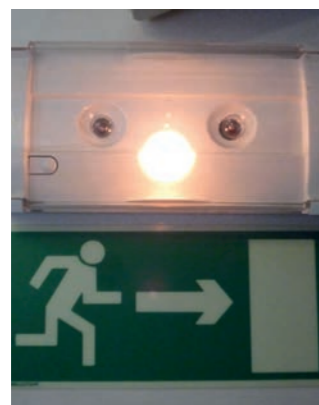
Balises des issues de secours
